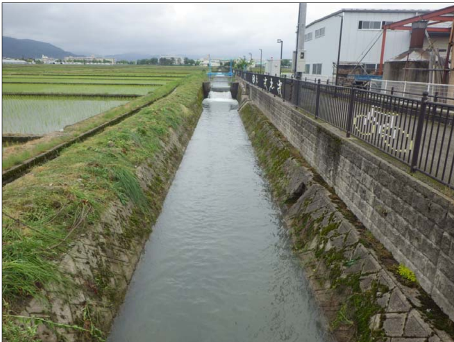
野々市市下林2丁目地内 富樫用水 延長約50m 草刈工 完了
